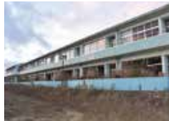
② 1階部分が津波に襲われた浪江町立浪江小学校の廊下。児童全員が無事だったそうです
